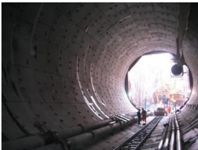
Рис. 7. Водопроявления в тоннеле
